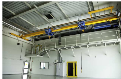
fot. 2 Pomieszczenie szkoleniowe z pomostem roboczym zapewniającym dostęp do suwnicy
